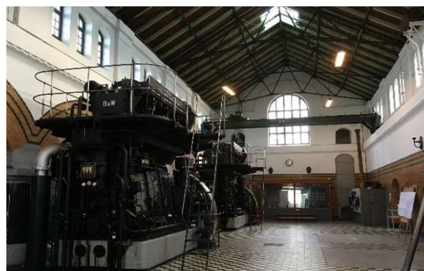
Foto anno 2021 af gl. Maskinhus' maskinhal med de fra 1934 opstillede B&W dieselmaskiner. Der er betragtelig forskel på pladskravet dengang og anno 1985 som se ovenfor.
