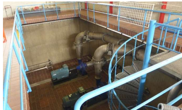
I 1985 opføres nyt maskinhus med elektriske trykpumper, der pumper råvand fra Reservoir ind til modtagerkommunerne og København. Grete Pontoppidan 2020 maj.
